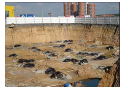
Abb. 2: Blick auf einen Teil des Erdwärmesondenfeldes nach Ende der Bohr- und Ausbaurbeiten (2007, Photo Form Group)
